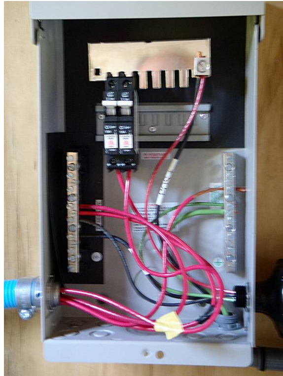
PV Combiner Box wiring
