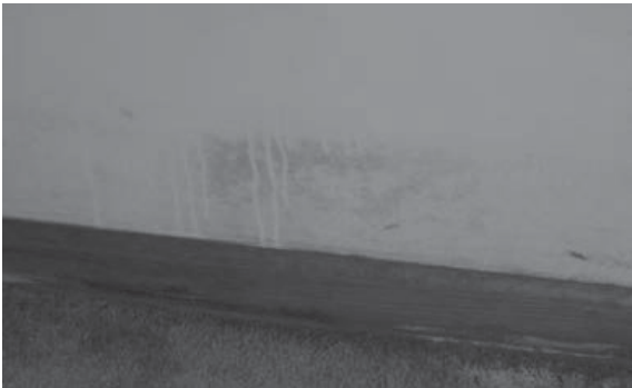
Mold on drywall
